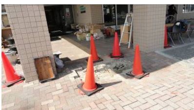
陥没した宮城野の里玄関付近
