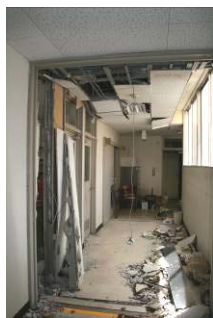
崩壊したクリニック内部
